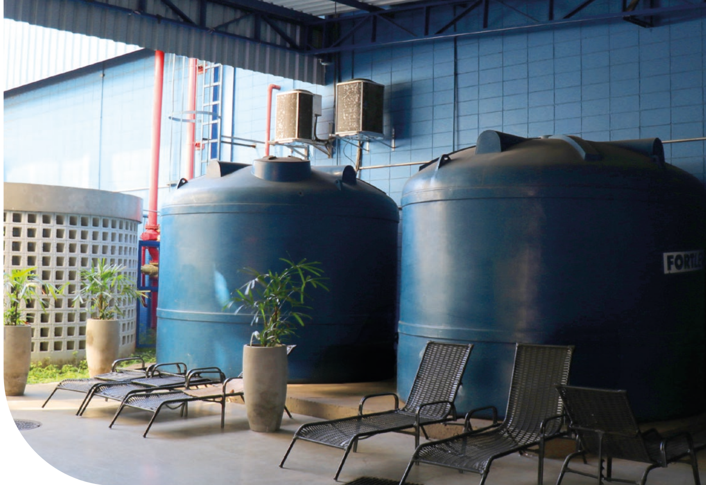
Reservatórios das águas de chuvas localizado na filial São Paulo, em Guarulhos (SP)
