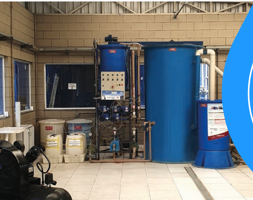
Sistema de tratamento de água na Matriz, em Guarulhos (SP)
