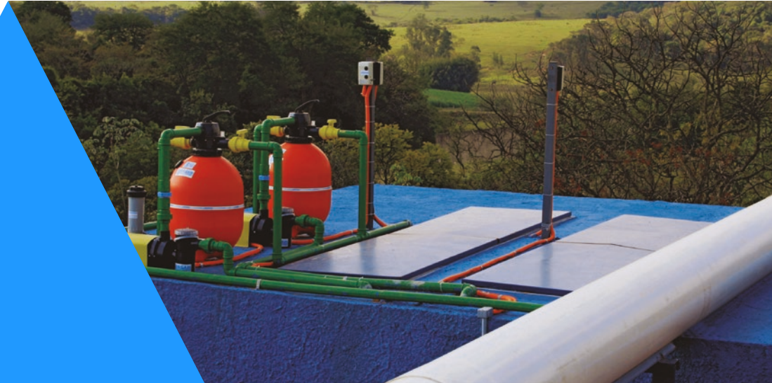
Sistema de captação de águas de chuvas
